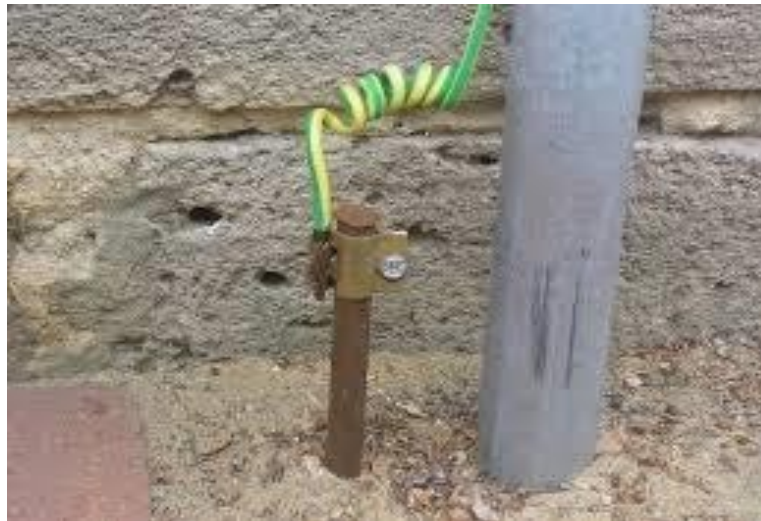
Ilustración 10: Toma de tierra
