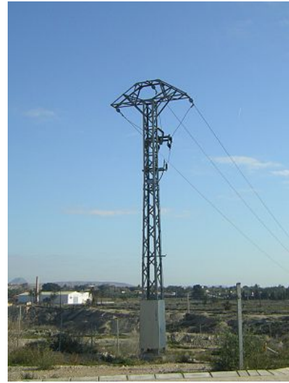
Ilustración 3: Torres y cables de Media Tensión
