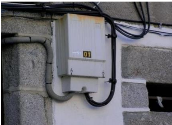
Ilustración 6: CGP instalado sobre fachada
