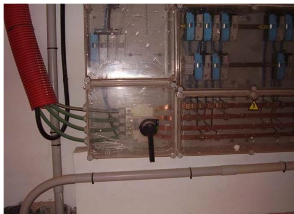
Ilustración 8: CGP en cuarto de contadores
