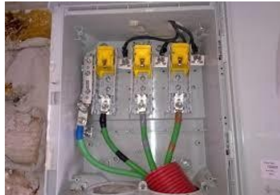
Ilustración 7: Interior CGP de exterior
