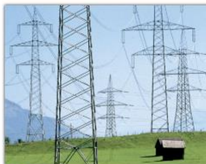
La red eléctrica.
